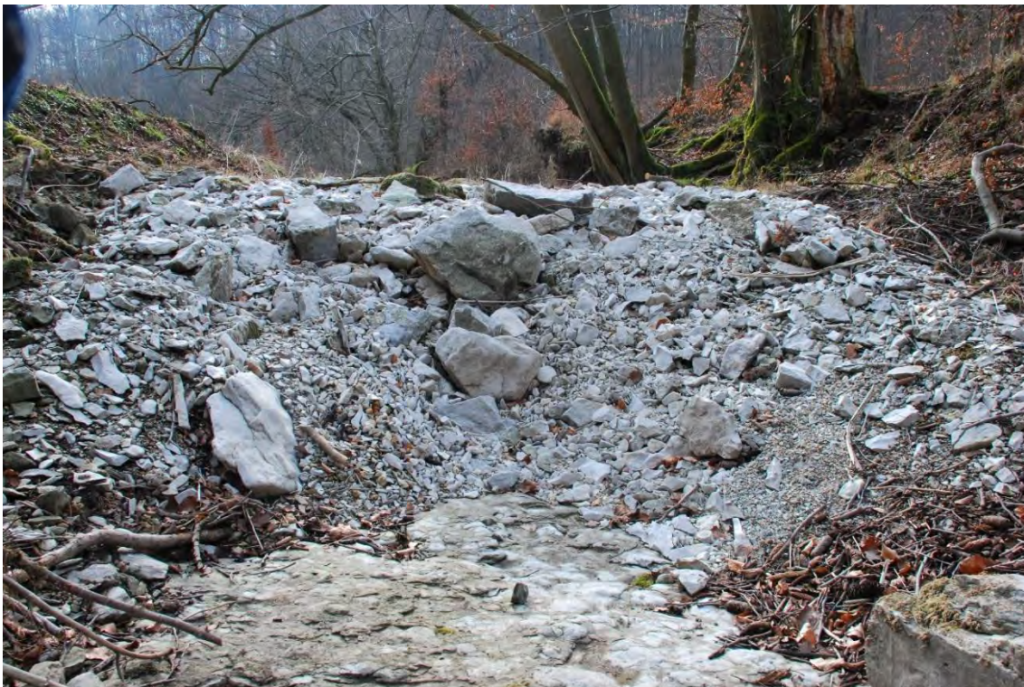
Abb. 8: Sedimentablagerung im Bachbett der Durbeke unterhalb der Brücke „Klingeweg“ über dem anstehenden Festgestein (Foto März 2018). Strömungstechnisch basierend auf einem Wechselsprung nach hoher Wassergeschwindigkeit im oberstrom liegenden Durchlass. (Foto März 2018)
